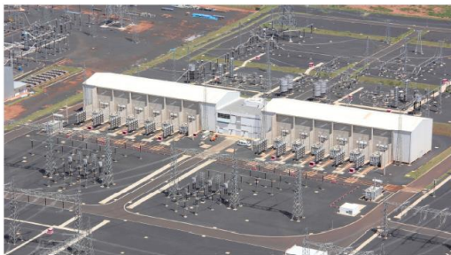
Fig. 3 – Bipolo 1 Complexo HVDC do Madeira - SE Araraquara 2.
