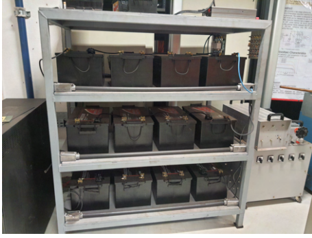
Figura 3. Estrutura do banco de baterias do BESS. Fonte: Autoria própria.
