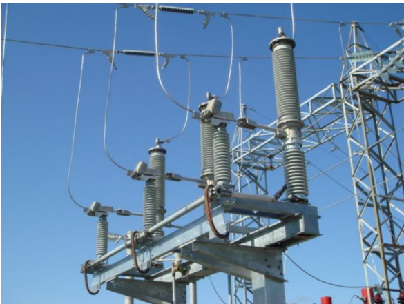
Fig. 9 Circuit switcher de 69 kV.
