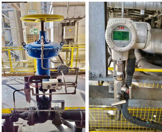
Figura 2. (a) Válvula de controle. (b) Transmissor de pressão.
