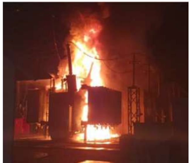
Figura 1. Falha do transformador de potência em Macapá.
