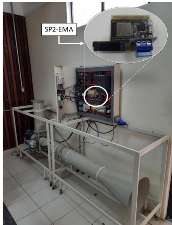
Fig. 5 Sistema de controle de exaustão.
