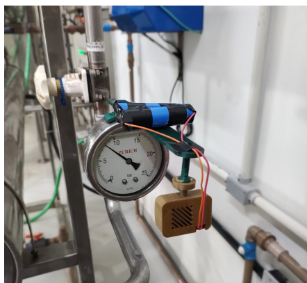
Figura 14. Manômetro operando no processo.
