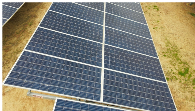
Figura 2. Imagem de painéis fotovoltaicos da planta base no CRESF/CHESF.
