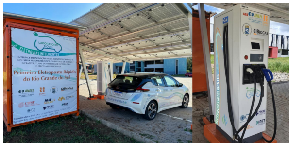
Figura 1. Eletroposto localizado em Santa Maria/RS.
