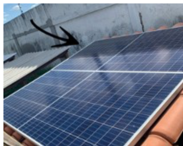
Fig. 8: Módulos com sombreamento. Fonte: os próprios autores.
