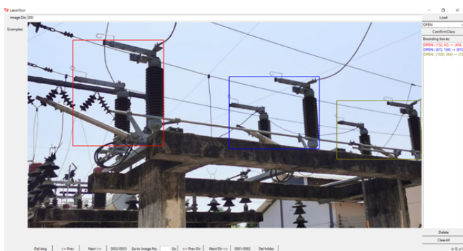
Figura 3. Demarcação das chaves seccionadoras.
