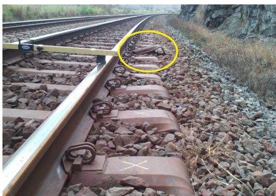
Figura 2. Evidência de fratura em um dormente de aço.
