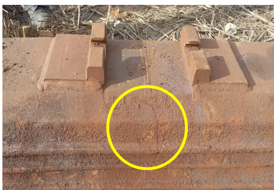
Figura 1. Evidência de trinca em um dormente de aço.
